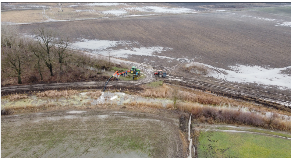
Szivattyúzás a Nagysertéséri csatornából a Szeghalmi gyűjtő csatornába
