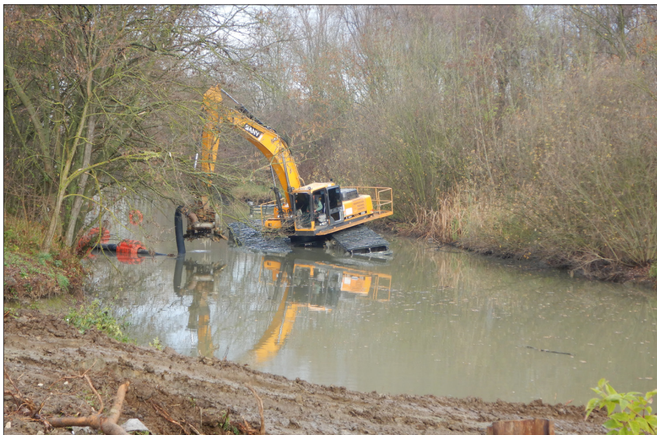
Úszókotró a Keryei szivattyútelepeknél
