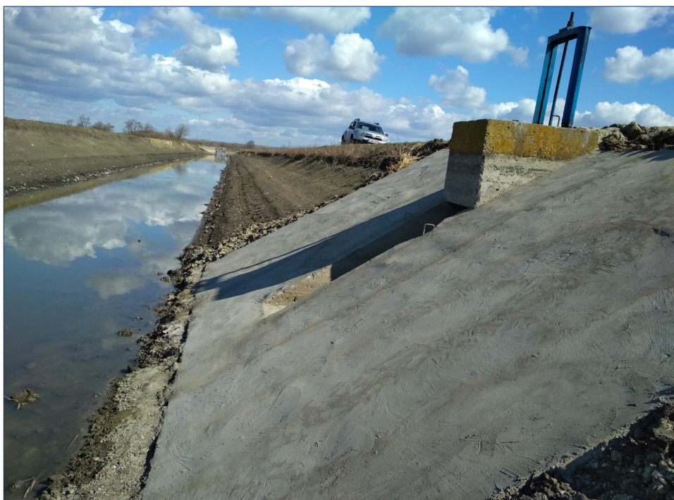
D-1 öntözőfőcsatorna javított oldalsó vízbeeresztő műtárgya
