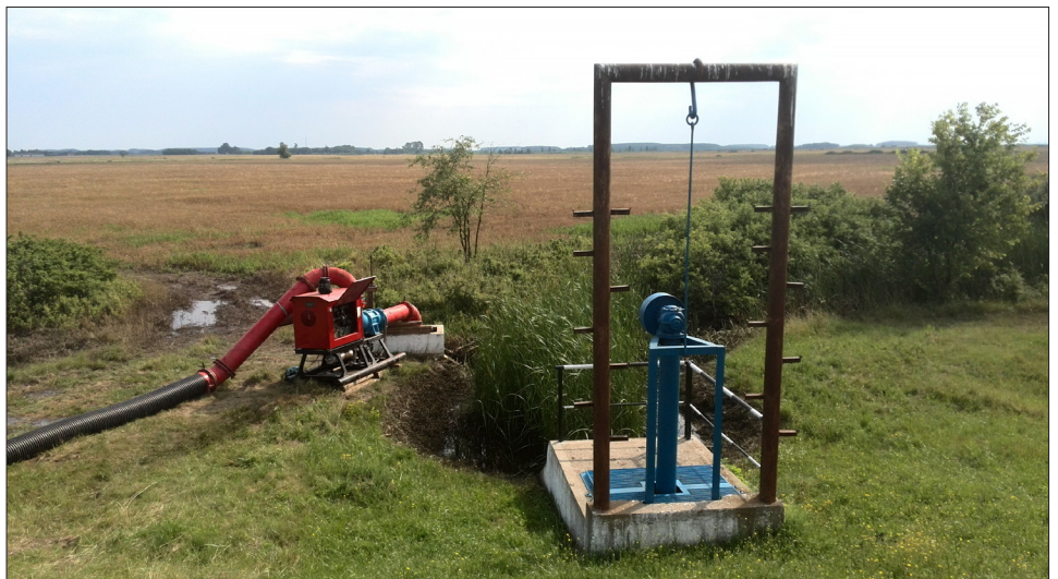
Telepített provizorium Korhányon
