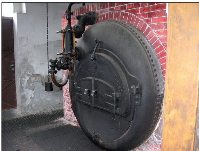
Békésszentandrás I. szivattyútelep kazán
