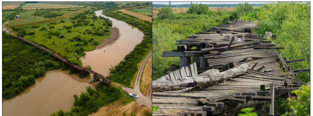
A megrongálódott Gyulavarsándi híd
