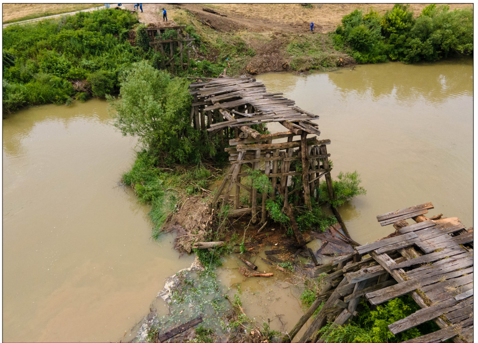
A híd jelentős részét néhány nap alatt elbontották a román szakemberek
