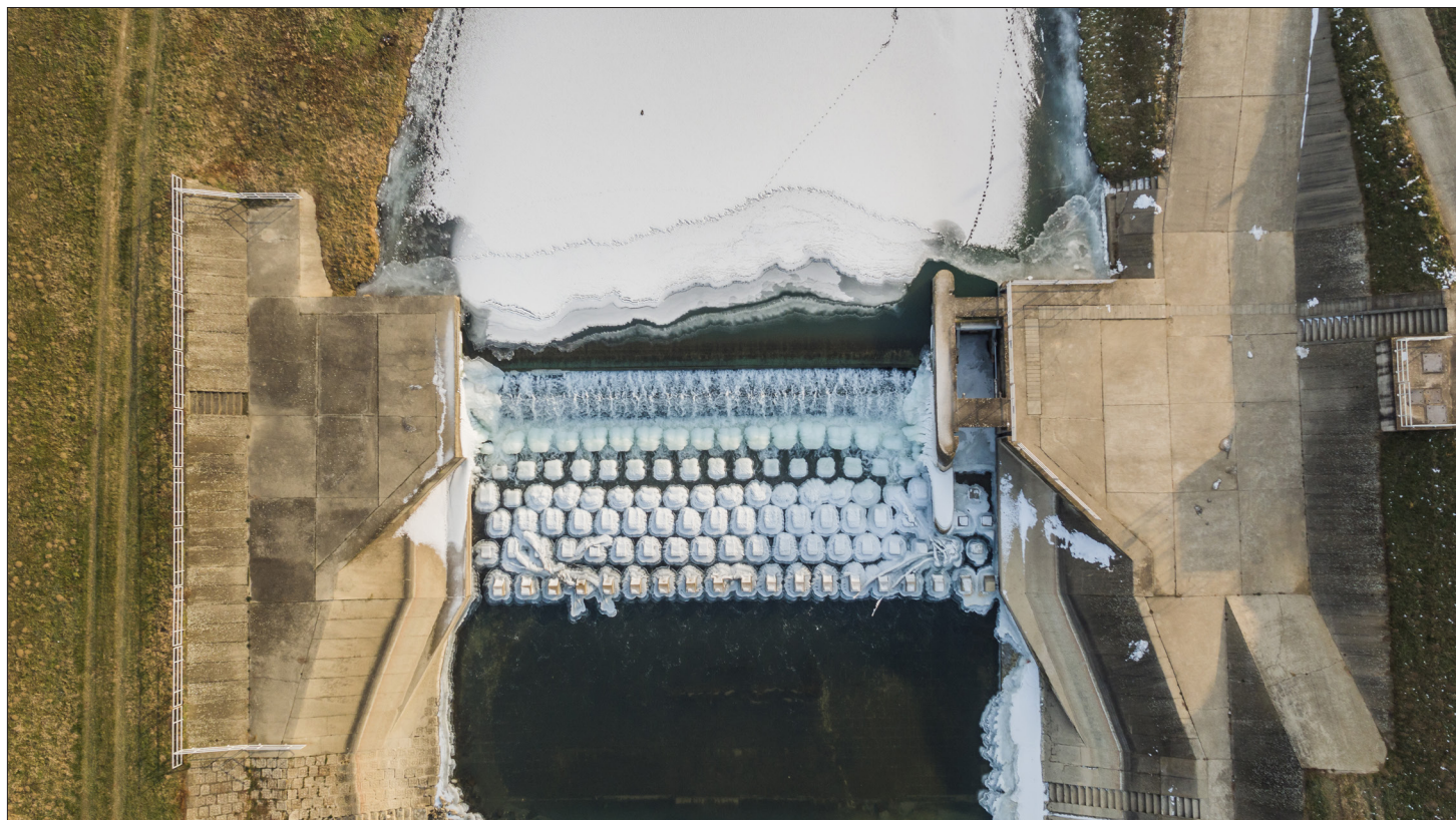
A tömlősgát jeges időszakban is üzemel
