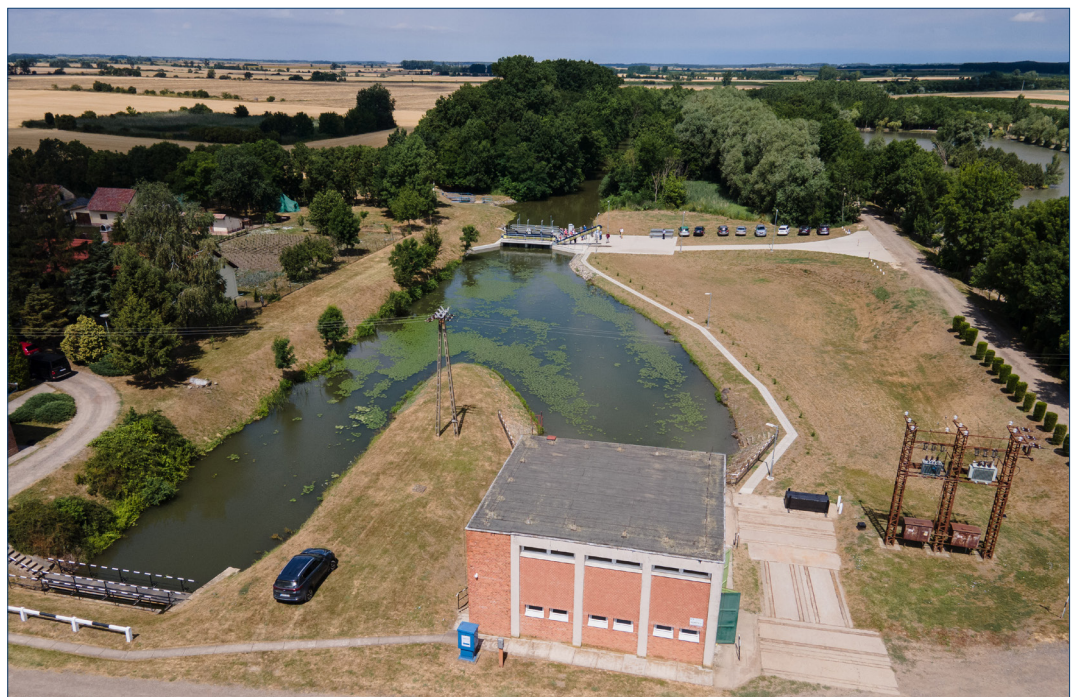
A Kernye szivattyútelep és a gépi gereb
