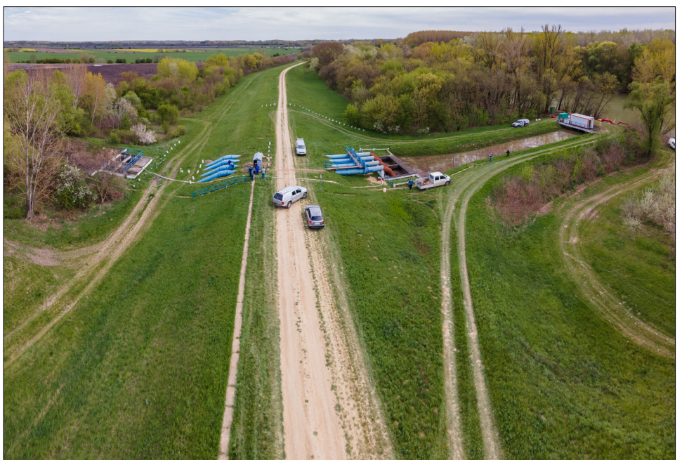
A Körösladányi fővízkivétel a szivornyákkal és a telepített szivattyúkkal
