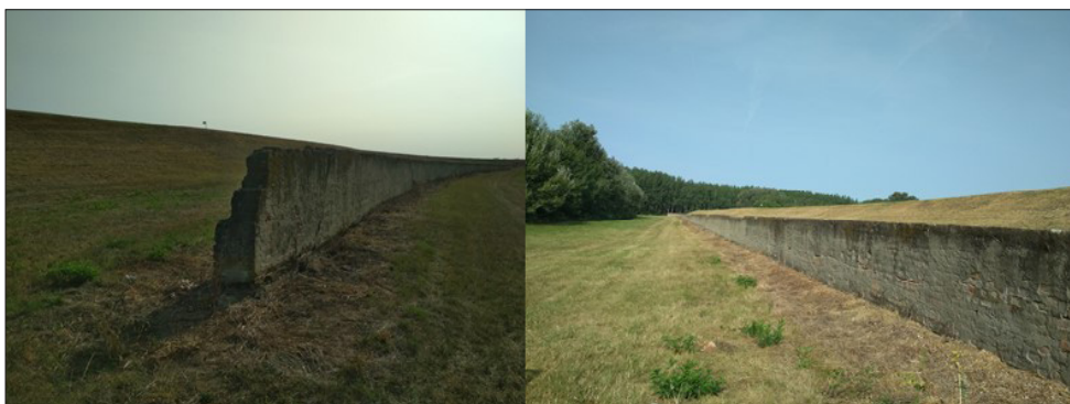
Kettős-Körös jobb oldali árvízvédelmi töltése 18+350-18+600 tkm között feltárt téglafal
