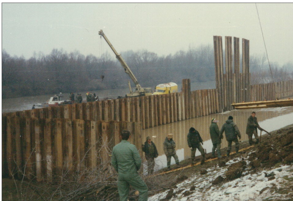
Víz visszavezetés a Mérgesi árvízi szükségtározónál
