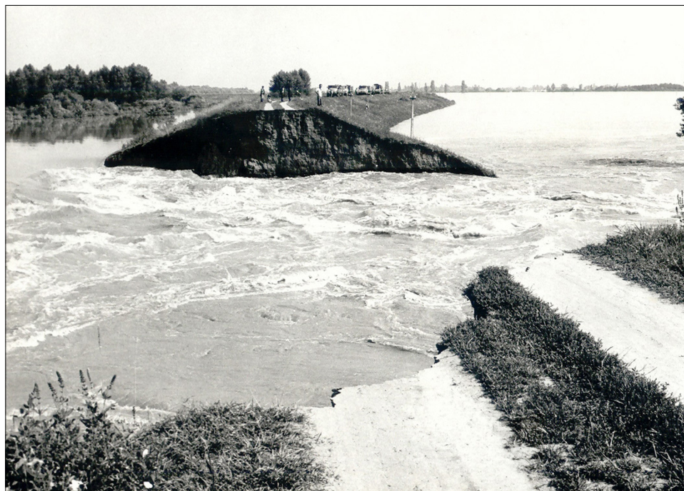
A Kettős-Körös jobb parti töltése a töltésszakadás után
