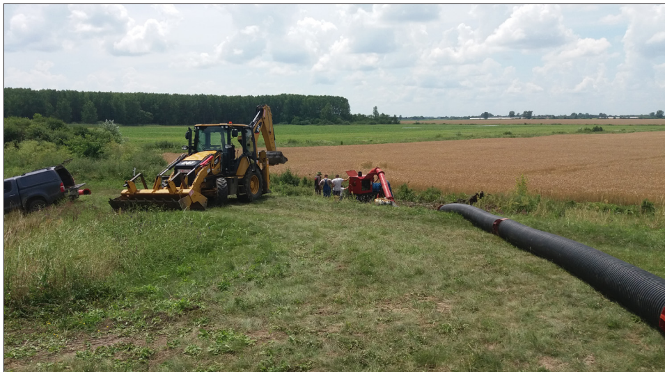
A Simonkeréki-csatornán telepített provizórium
