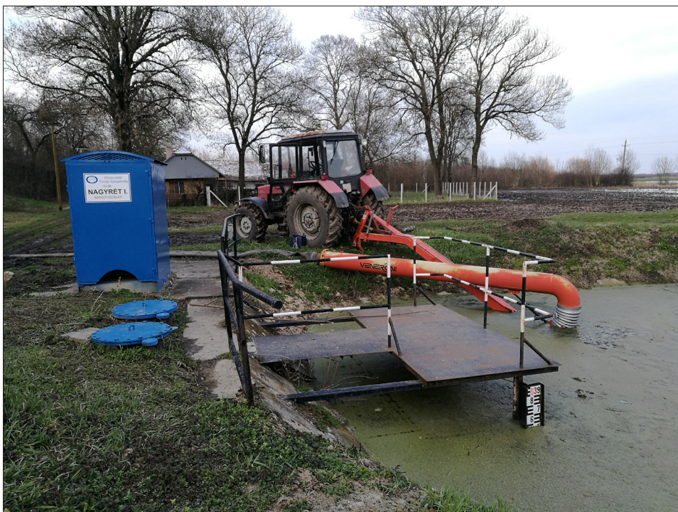
Kapacitás növelés traktor hajtású szivattyúval a Nagyretti szivattyútelepnél
