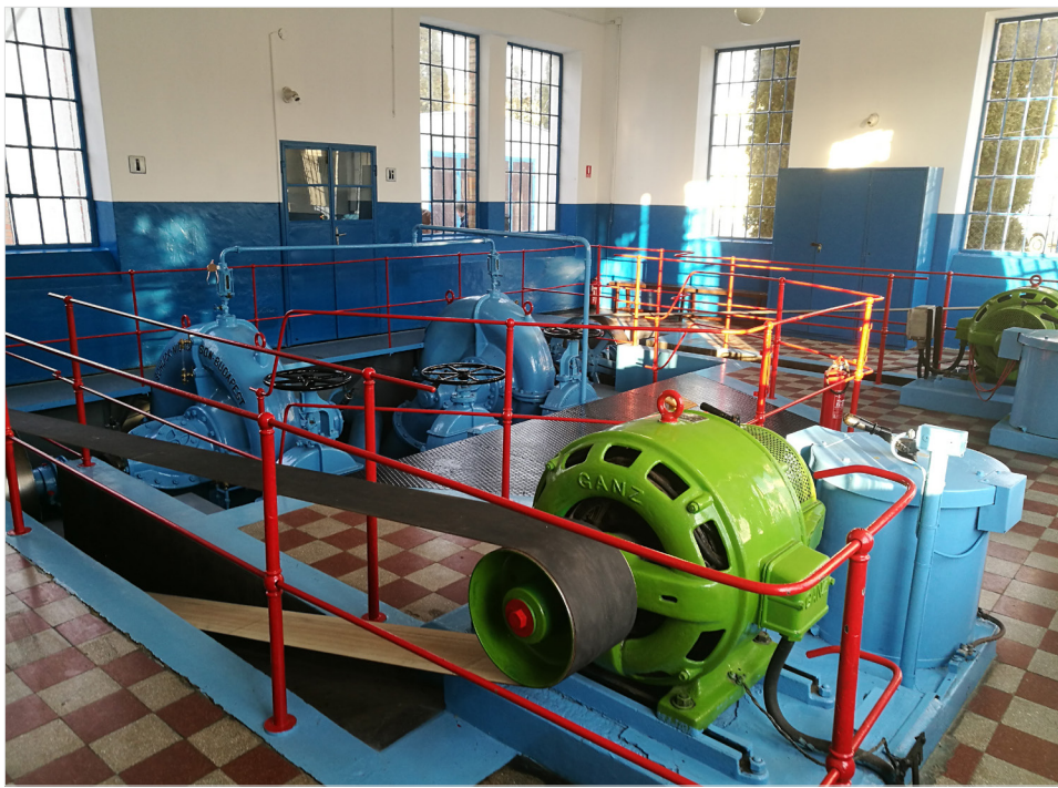
A Tápéi szivattyútelep régi gépegységei
