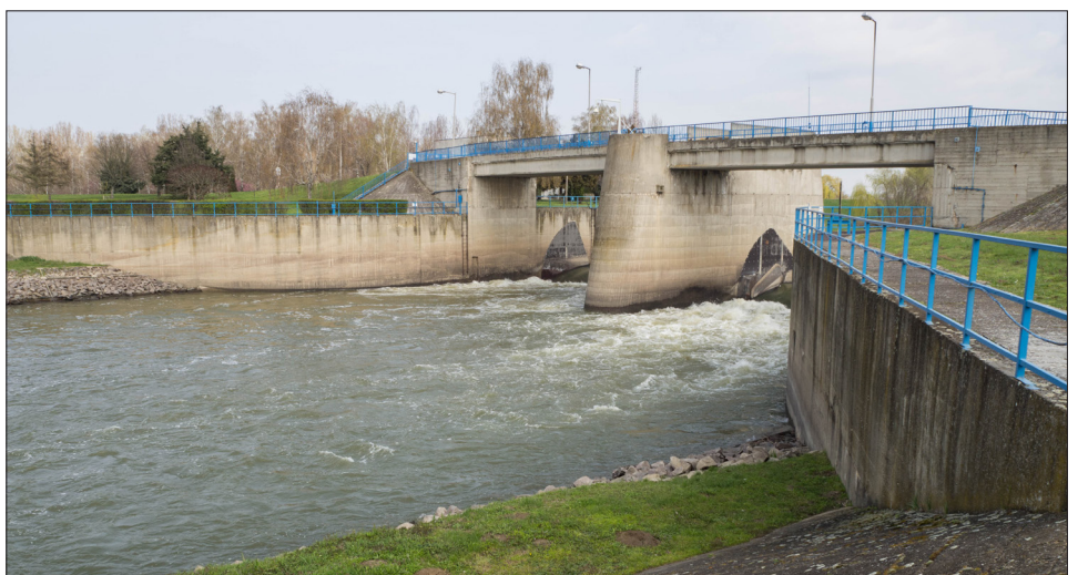
A rekonstrukcióra váró Körösladányi duzzasztó
