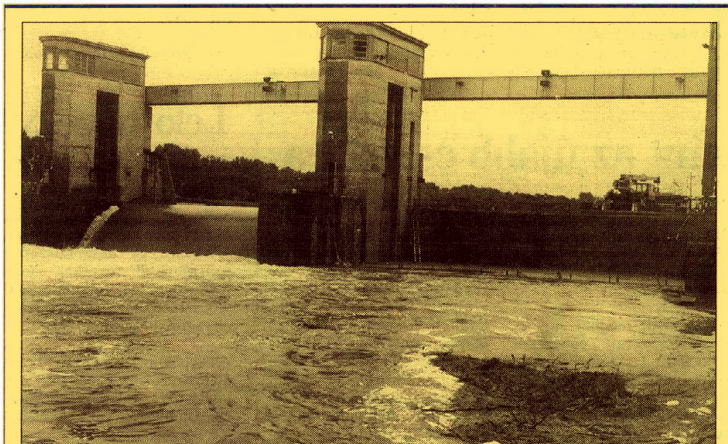
A békésszentandrás duzzasztó rekonstrukciója félbemaradt, az alvz elöntötte (képünk jobb oldalán) a munkaterületet
