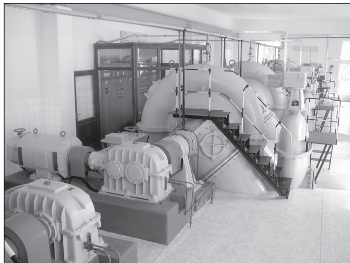
Hosszúfok II. szivattyútelep
